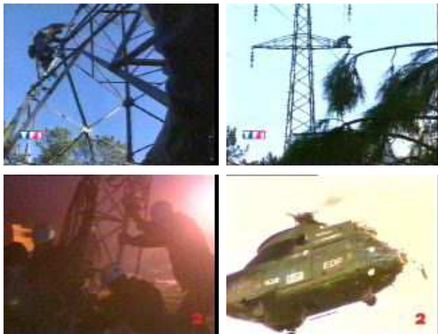
Figure 7 Extraits télévisés des interventions des lignards pour la réalimentation du réseau à la suite des tempêtes de décembre 1999
