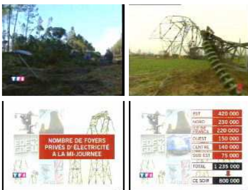
Figure 6 Extraits télévisés dévoilant les dégâts entraînés par les tempêtes de décembre 1999 sur une partie du réseau d'alimentation et le nombre de foyer à la mi-journée du 27.
